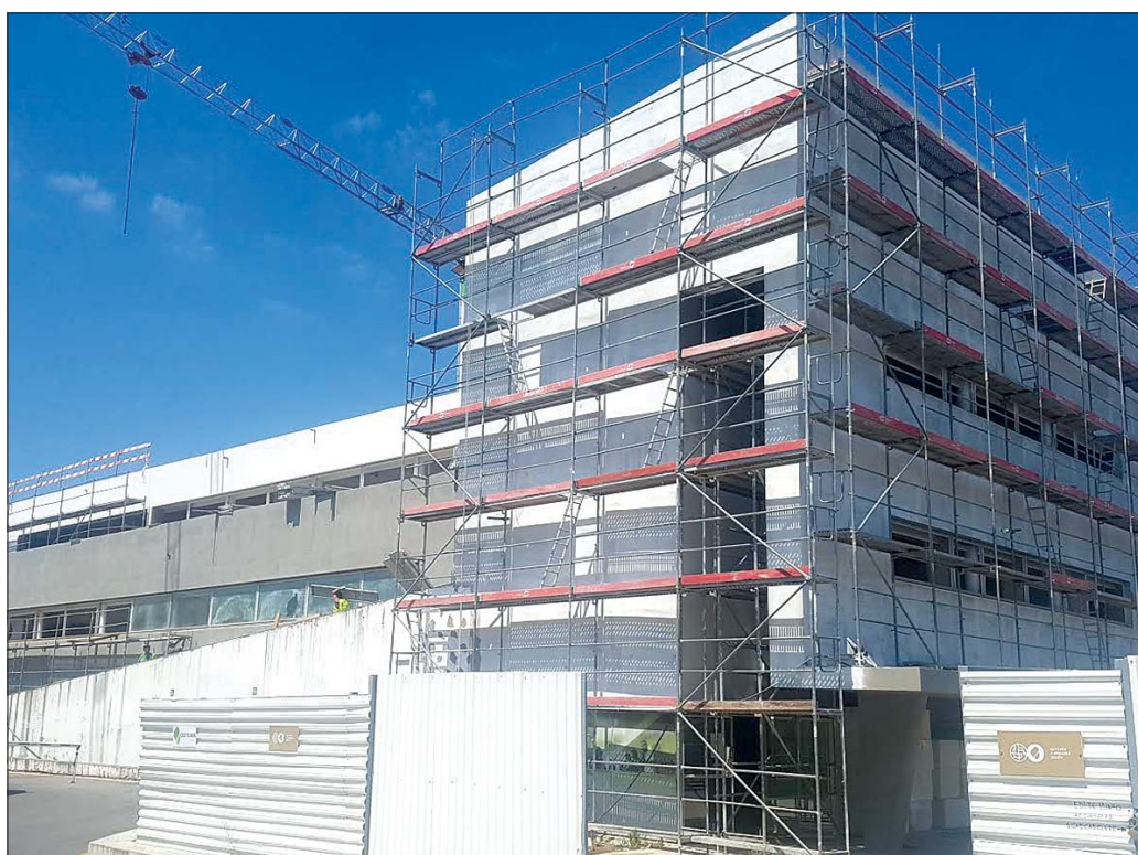
As obras já arrancaram e deverão ficar concluídas em fevereiro do próximo ano
